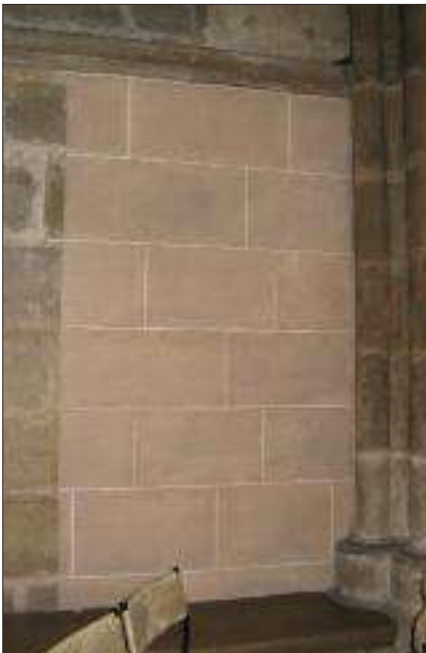
Restaurierte Wandfläche mit Quader-nachbildung
